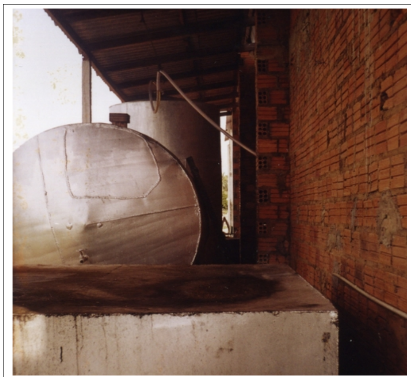
FIGURA 7: Tonéis para armazenamento de óleo da COPPALJ em Lago do Junco/MA
